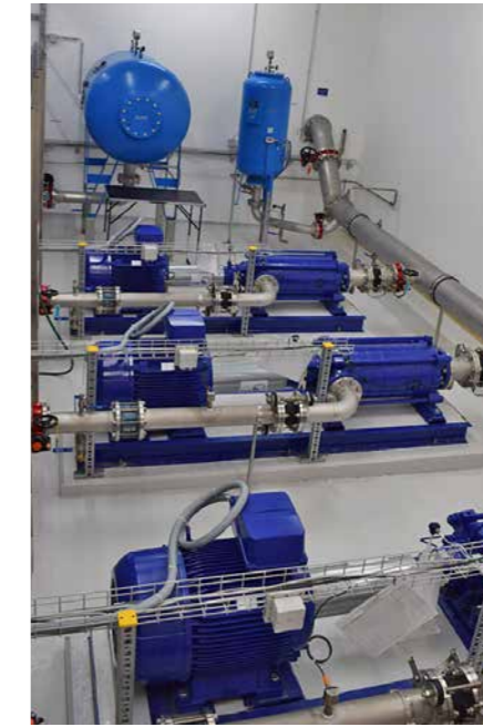
Station de pompage de Delley-Portalban. (2017)
