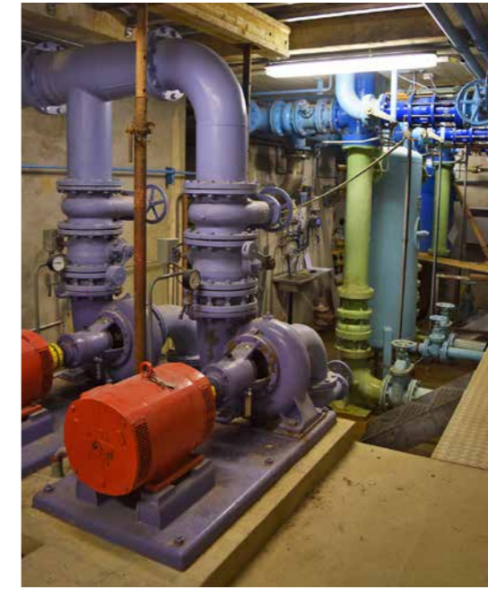
Station de filtration à Portalban.
