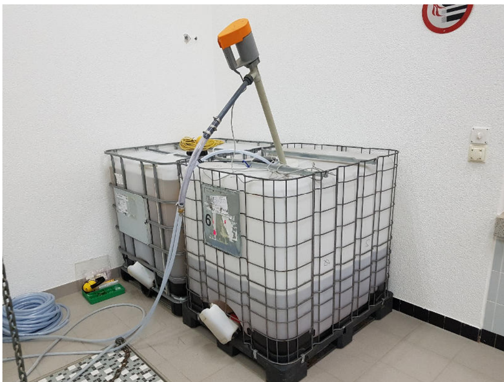
Réservoirs de réactif du système de dosage WAC provisoire, dans la salle des filtres
