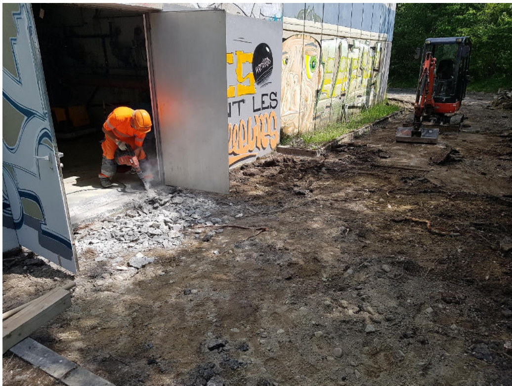
Démontage du seuil et de la place d'accès à l'arrière du bâtiment
