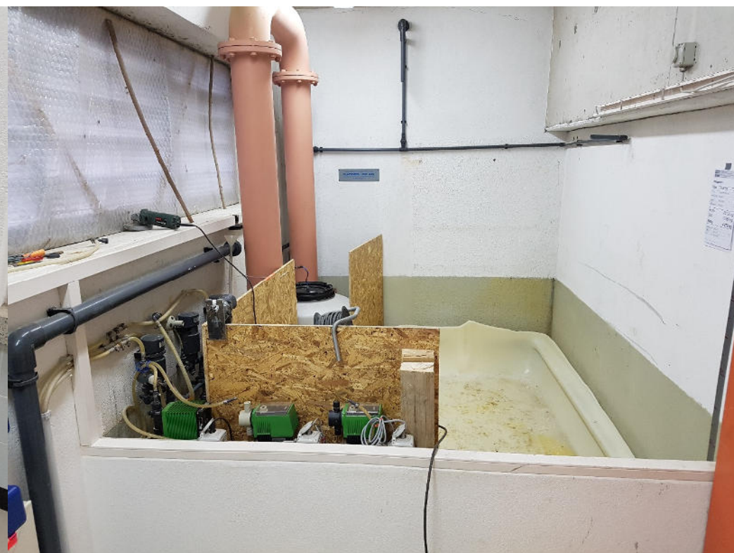
Système de dosage WAC provisoire protégé avec des planches, et ancienne cuve WAC partiellement démantelée
