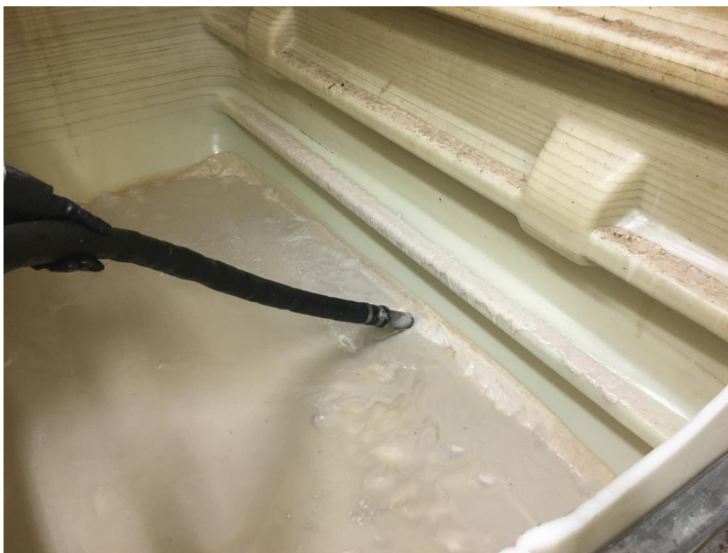
Curage des boues et résidus de WAC dans la cuve pour évacuation et élimination à CRIDEC
