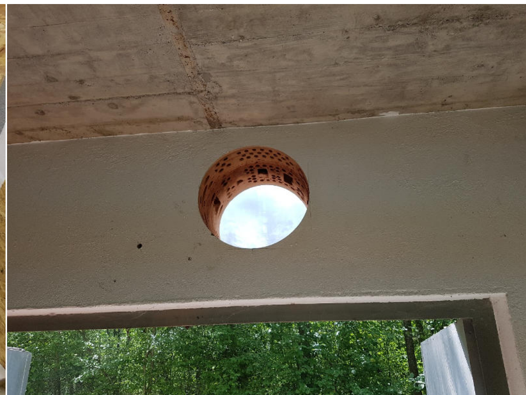
Carottage d'un trou dans le mur de la halle principale pour le système de ventilation
